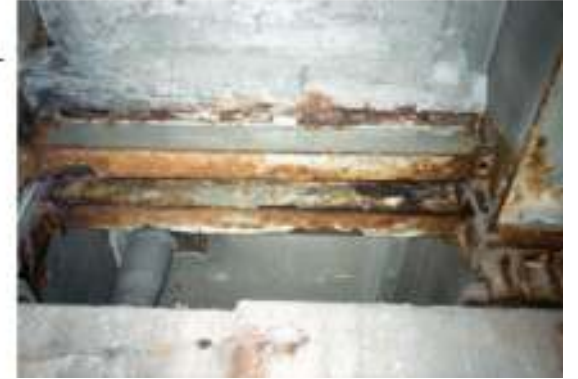
Bir köprünün alt bölümleri üzerinde oluşan pas
